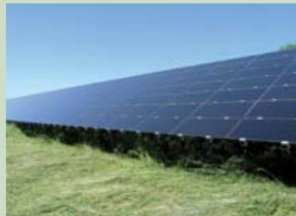
Stromproduktion im Rodachtal – Freiflächensolaranlage
