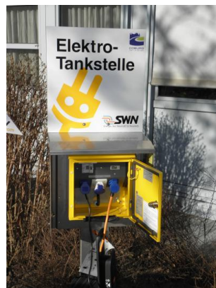
Abbildung 12: Die neue SWN-Elektrotankstelle vor dem Coburger Landratsamt, Quelle: Energieagentur Nordbayern
